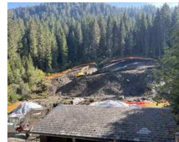
D'importants travaux d'excavation ont été effectués afin de s'assurer du respect de l'ordonnance sur l'assainissement des sites pollués, notamment en raison de la proximité du stand de tir avec un cours d'eau.
